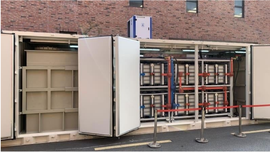
レドックス・フロー電池 内部写真
