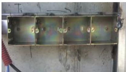
①埋め込みボックスを固定するために、補強台を設置
